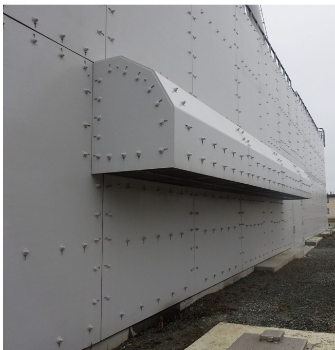
フード（吸気側）の設置状況
