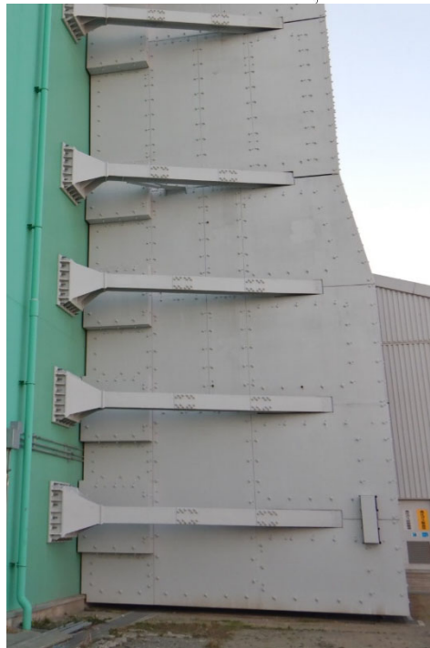
建屋壁面と地表面の隙間状況
