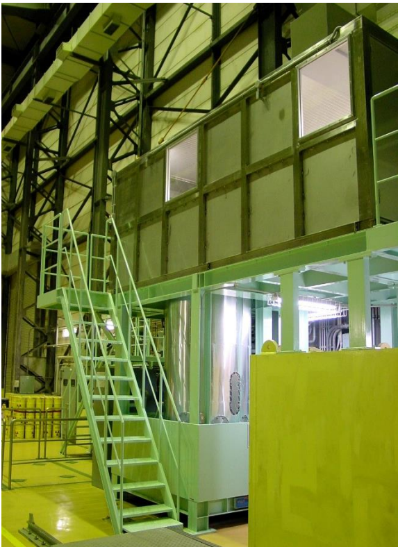
洗浄設備 (外観)
