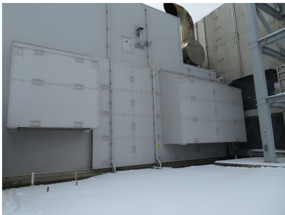
飛来物防護板 写真(A系統 北面)
