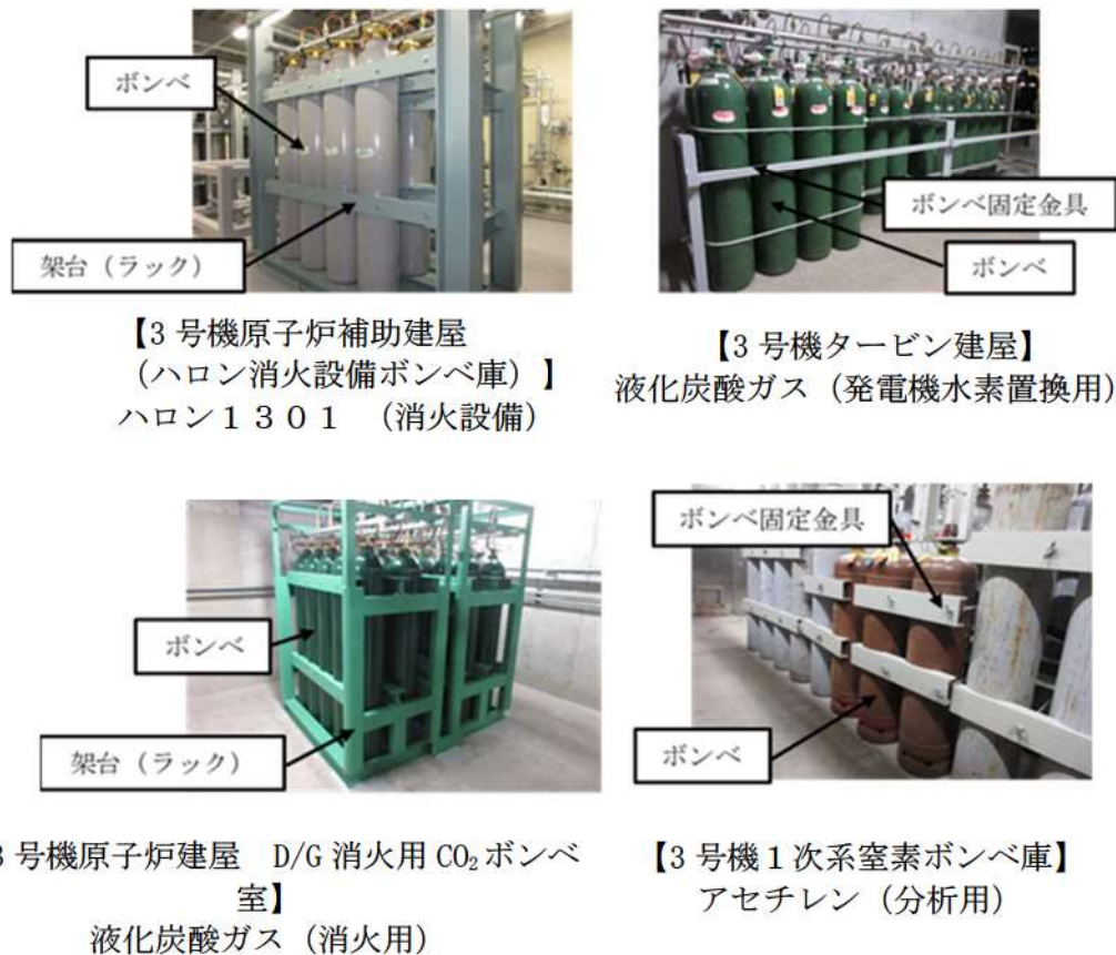
図1 発電所におけるガスボンベの保管状況
