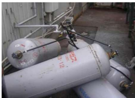
東日本大震災でのLPガスボンベの被災状況の一例
