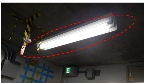
図 1 蓄電池照明設置例
