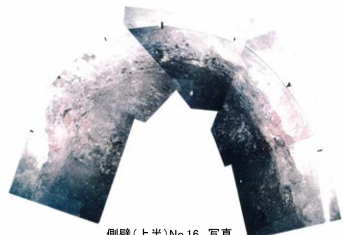
側壁(上半)No.16 写真
