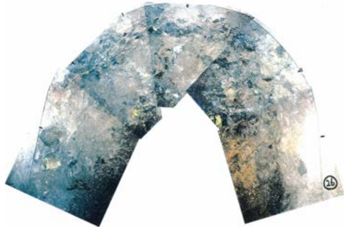
側壁(上半)No.26 写真
