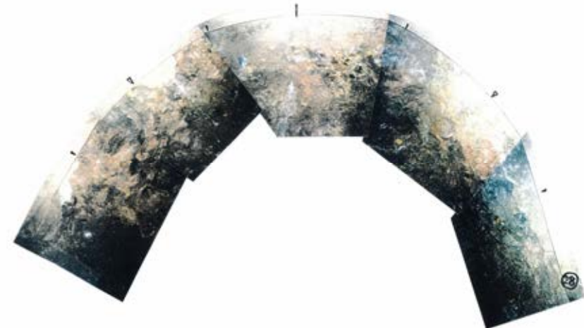
側壁(上半)No.28 写真
