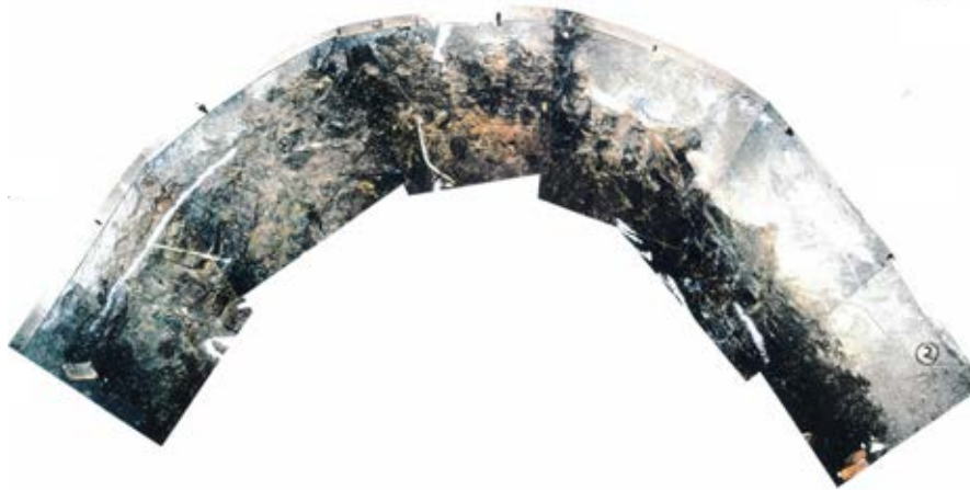
側壁(上半)No.2 写真
