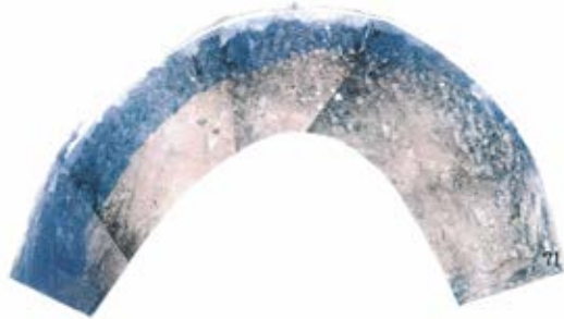
側壁(上半)No.71 写真
