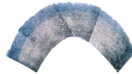
側壁(上半)No.76 写真
