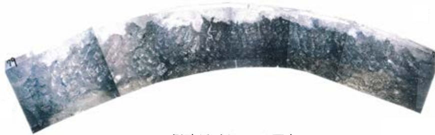
側壁(上半)No.79 写真
