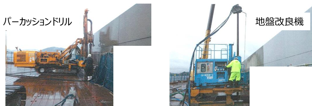
図2-4 高圧噴射攪拌工法によるケーソン中詰材改良の施工状況
