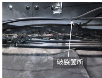
(感知チューブ溶損箇所)
