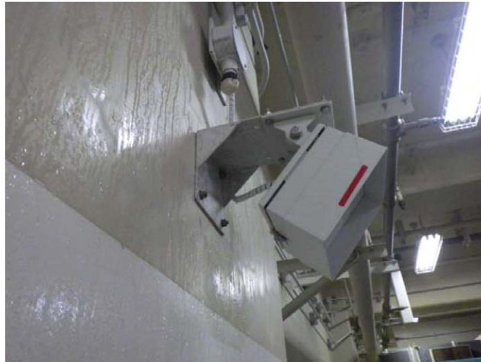
図7-6-1-3 焼却炉建家の地下1階フロアの結露状況
