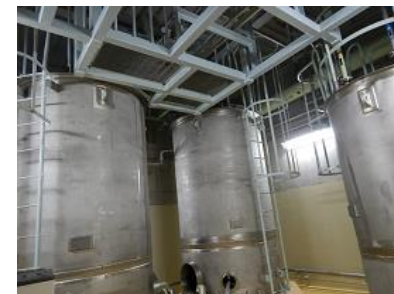
廃液調整タンク
