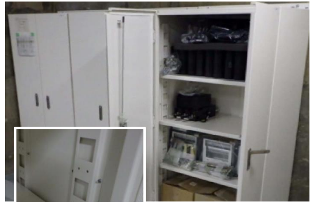
キャビネットの内部
