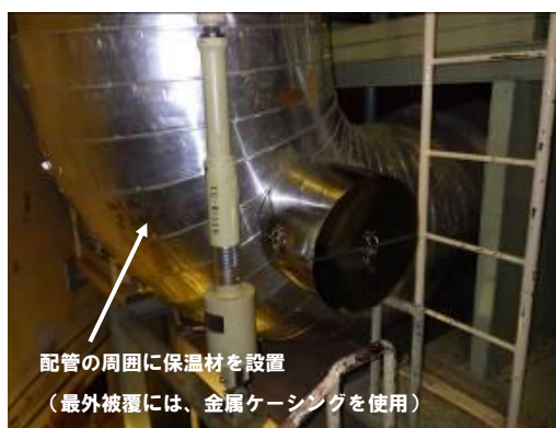
(1次主冷却系の配管)
