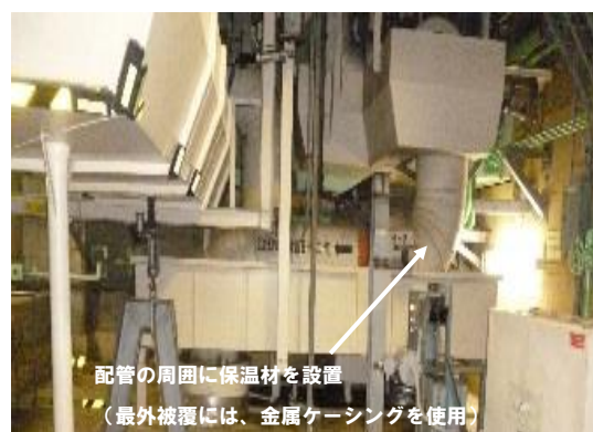
(2次主冷却系の配管)
