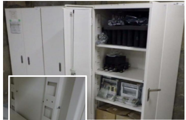
キャビネットの内部
