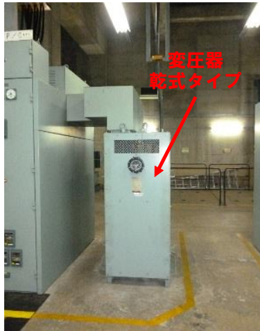
第 3.1 図 変圧器の一例
