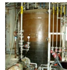
排水処理設備の例 (廃液槽)
