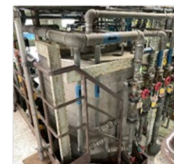
オフガス処理設備の例 (スクラバ)
