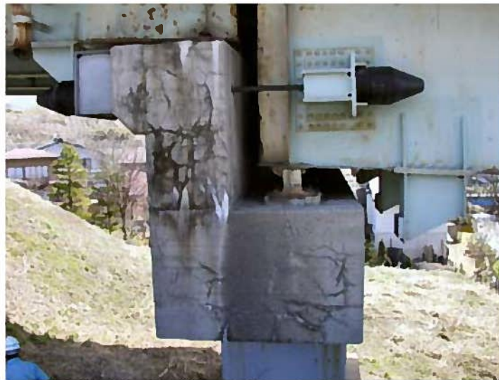
図 3. 2. 4-3 実構造物における膨張ひび割れ（亀甲状）の事例 7)
