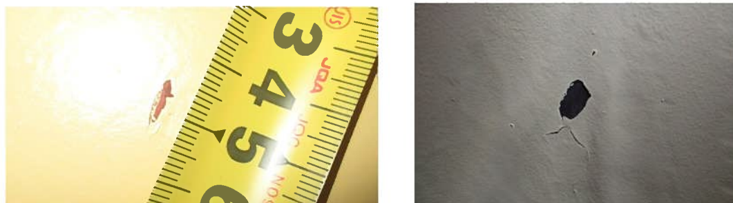
フロー②、③と判断した塗膜の劣化
