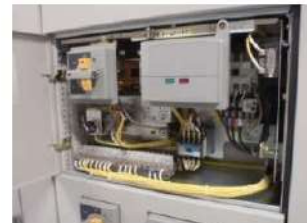
コントロールセンタ
