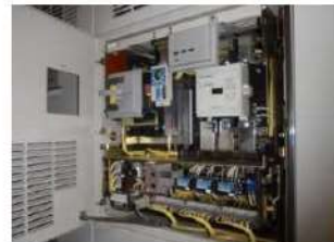
パワーコントロールセンタ
