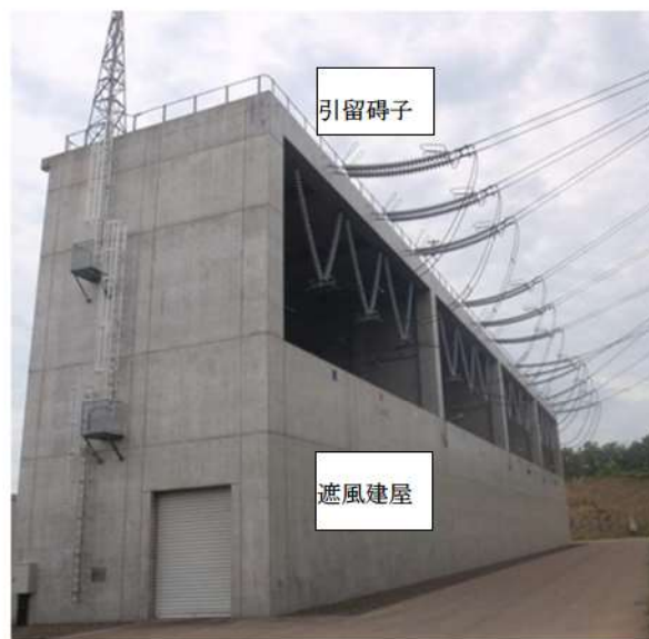
第 5.1 図 275kV 架線部 (引留碍子)
