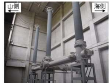
ポリマー碍管 (遮風建屋内)
