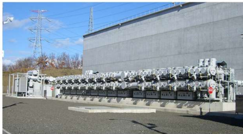
第 2.2.4.6 図 開閉所設備外観
