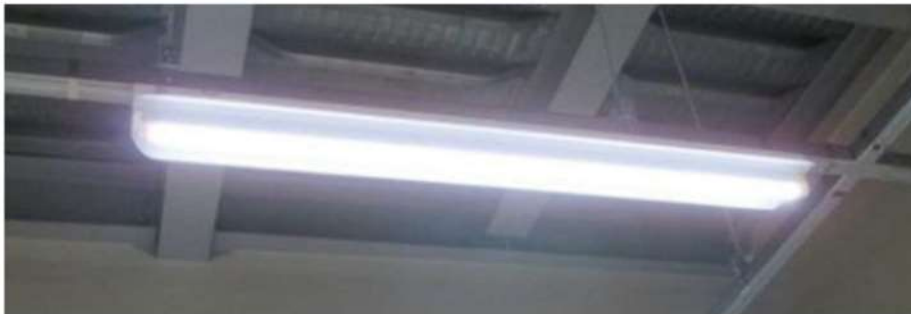
無停電運転保安灯
