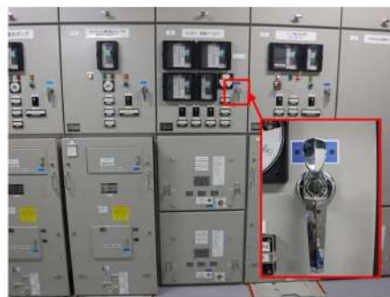
電源盤の施錠
