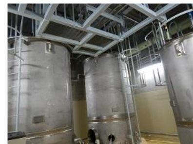
廃液調整タンク
