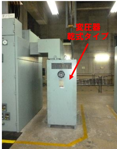
第 3.1 図 変圧器の一例
