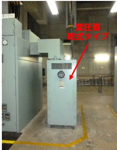
第 3.1 図 変圧器の一例
