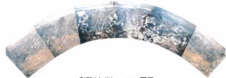
側壁(上半)No.193 写真
