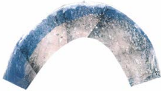
側壁(上半)No.71 写真
