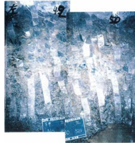
側壁(下半南側)No.49~50 写真 No.48, 51~54 写真なし
