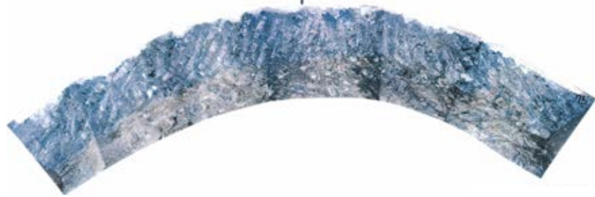
側壁(上半)No.75 写真
