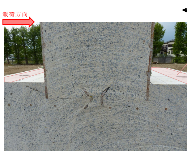
図 2.3.2-5 杭頭内部のひび割れ状況
