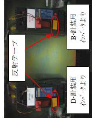
【盤扉開放状態】
