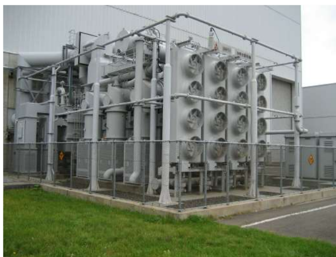
第1図 変圧器外観
