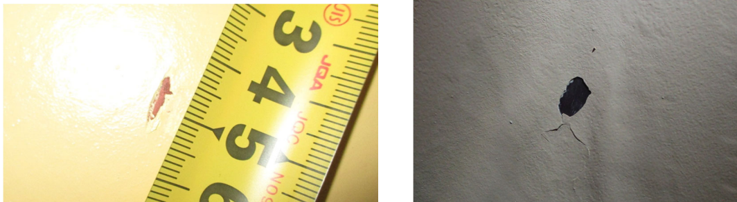
フロー②、③と判断した塗膜の劣化
