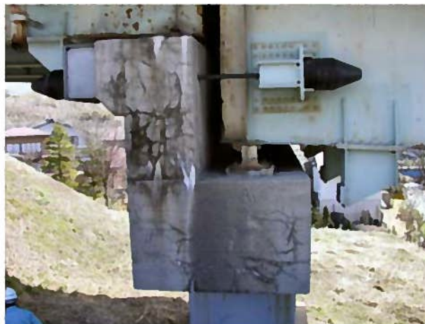
実構造物における膨張ひび割れ（亀甲状）の事例 2)
