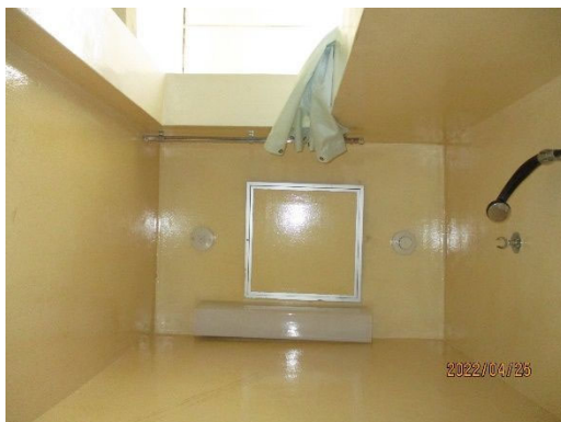
第 3-9-6 図 アスファルト固化建屋のシャワー室配置図及び現場状況
