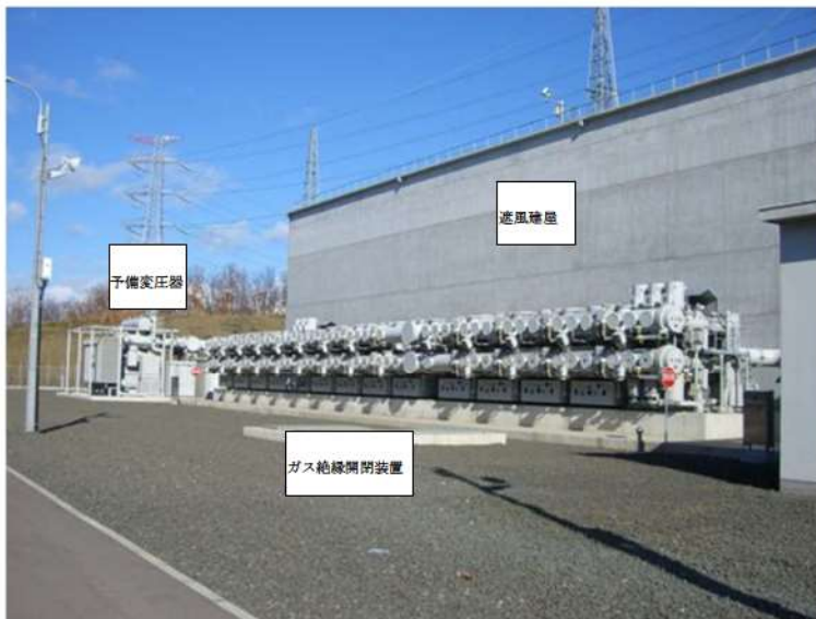
275kV GIS (架線部なし)
