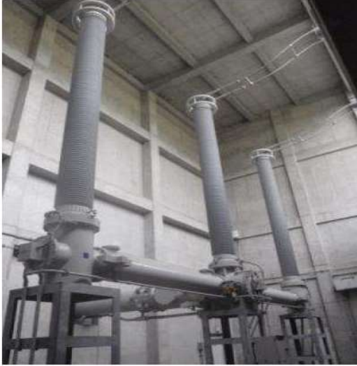
275kV ブッシングの外観
