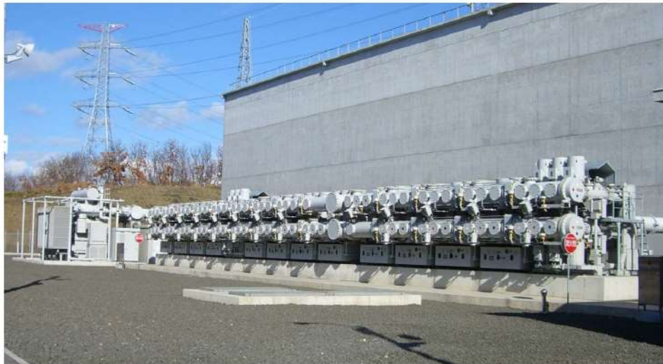
開閉所 275kV ガス絶縁開閉装置
