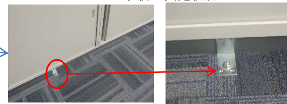
運転指令卓後ろの ラックの固定状況
