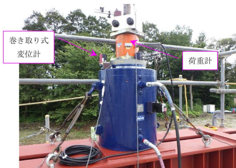
図 3-7 計測機器設置状況
