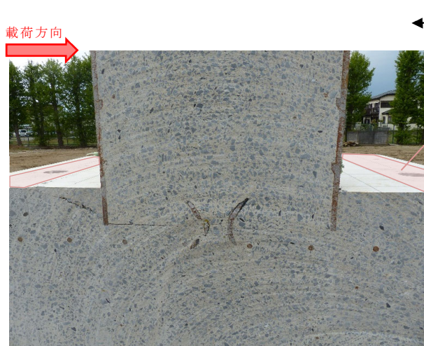
図 2.3.2-5 杭頭内部のひび割れ状況
