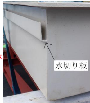
水切り板状況
