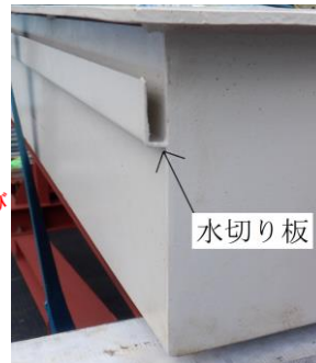
水切り板状況
