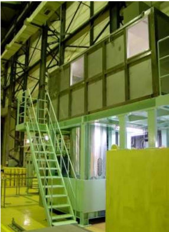
洗浄設備 (外観)
