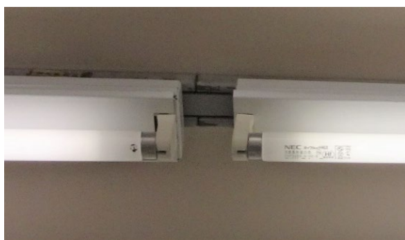
第2図 中央制御室天井照明
