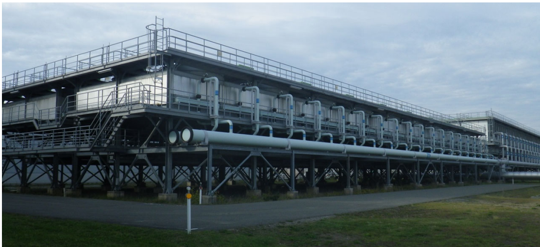
2. G2 常用冷却水設備：冷却塔
