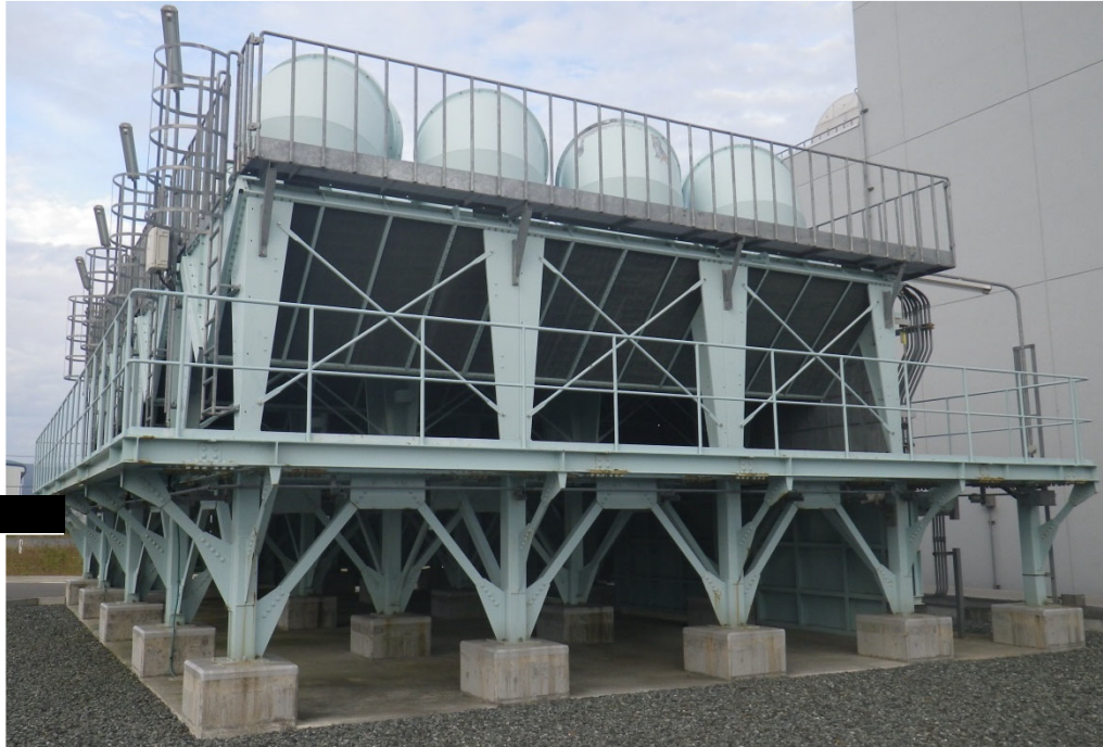
14. GC2 第2ユーティリティ建屋：冷却塔 A/B/C/D
