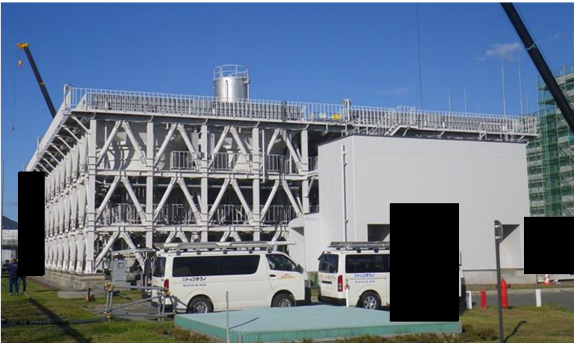
20. 使用済燃料受入れ・貯蔵施設用冷却水設備： 安全冷却水系冷却塔 B/膨張槽 B
