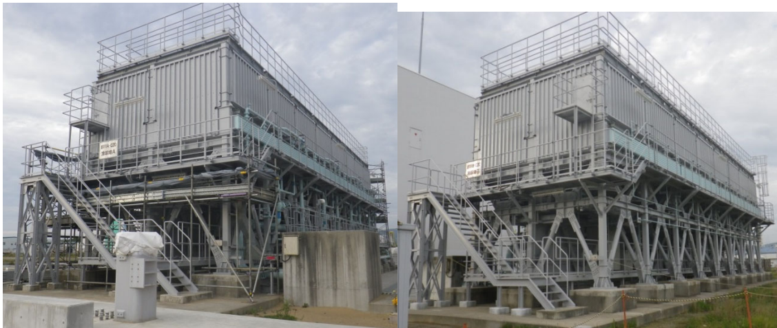
16. G10 非常用電源建屋 冷却水設備：冷却塔 A/B
