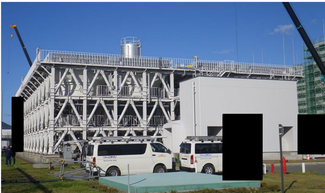
20. 使用済燃料受入れ・貯蔵施設用冷却水設備： 安全冷却水系冷却塔 B/膨張槽 B
