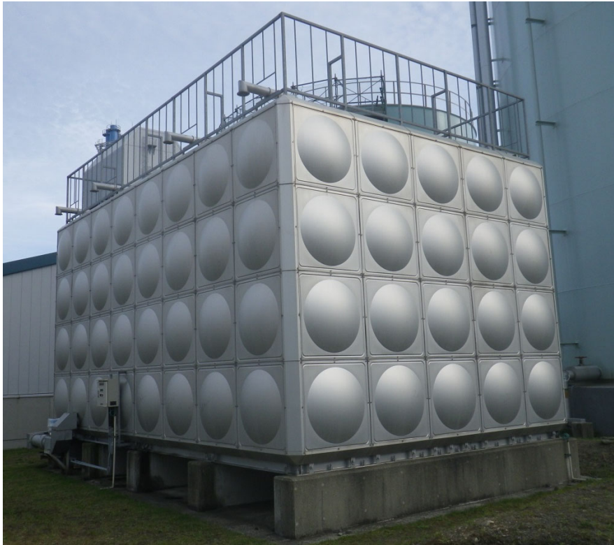
7. G6 工業用水施設：飲料水増設貯槽
