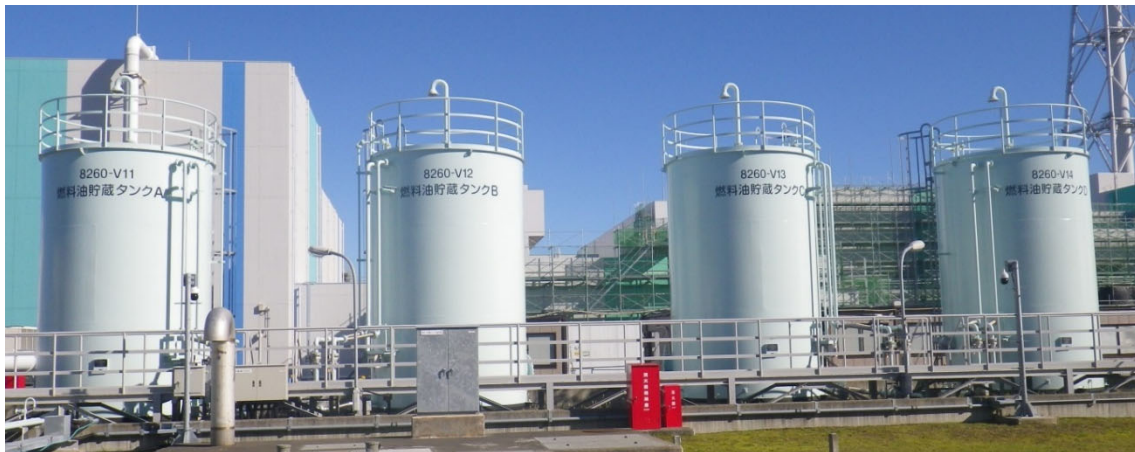
8. G7 ディーゼル発電機設備用燃料油受入れ・貯蔵所： 燃料油貯槽タンク A/B/C/D
