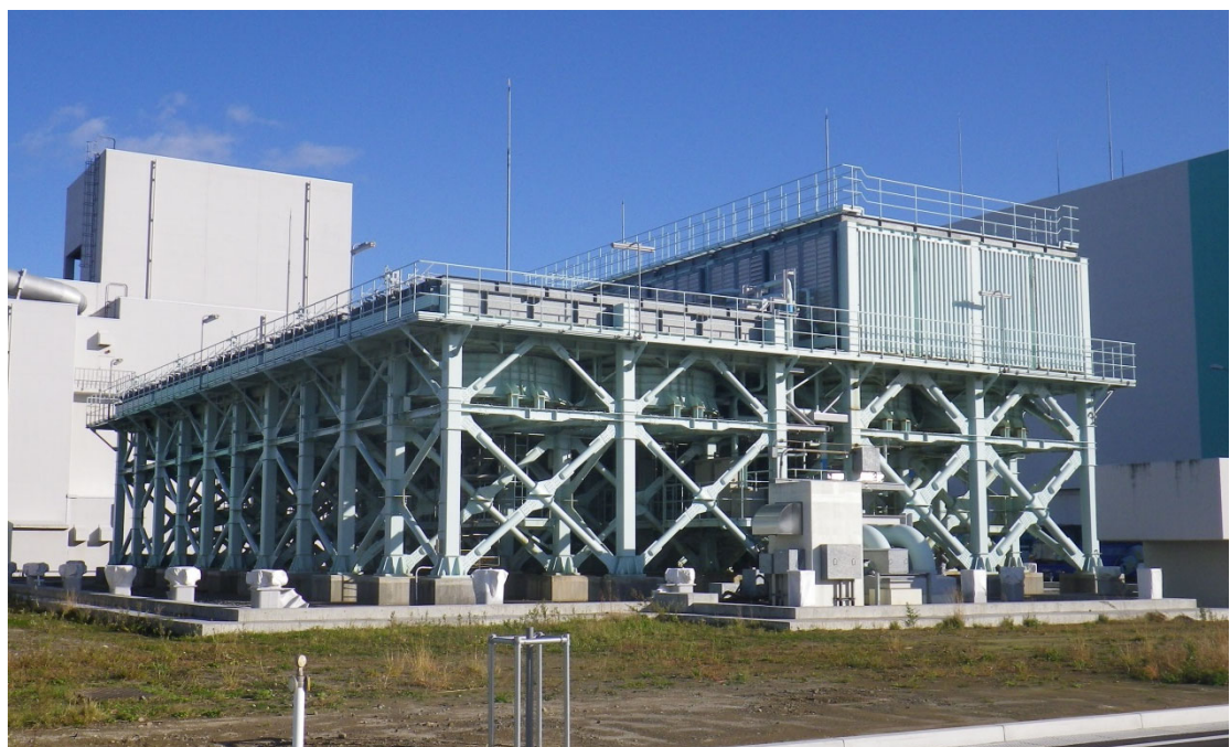
18. 冷却水設備：安全冷却水 B 冷却塔
