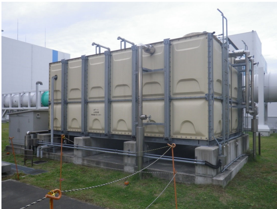
15. H2W 再処理事務所 西棟：受水槽
