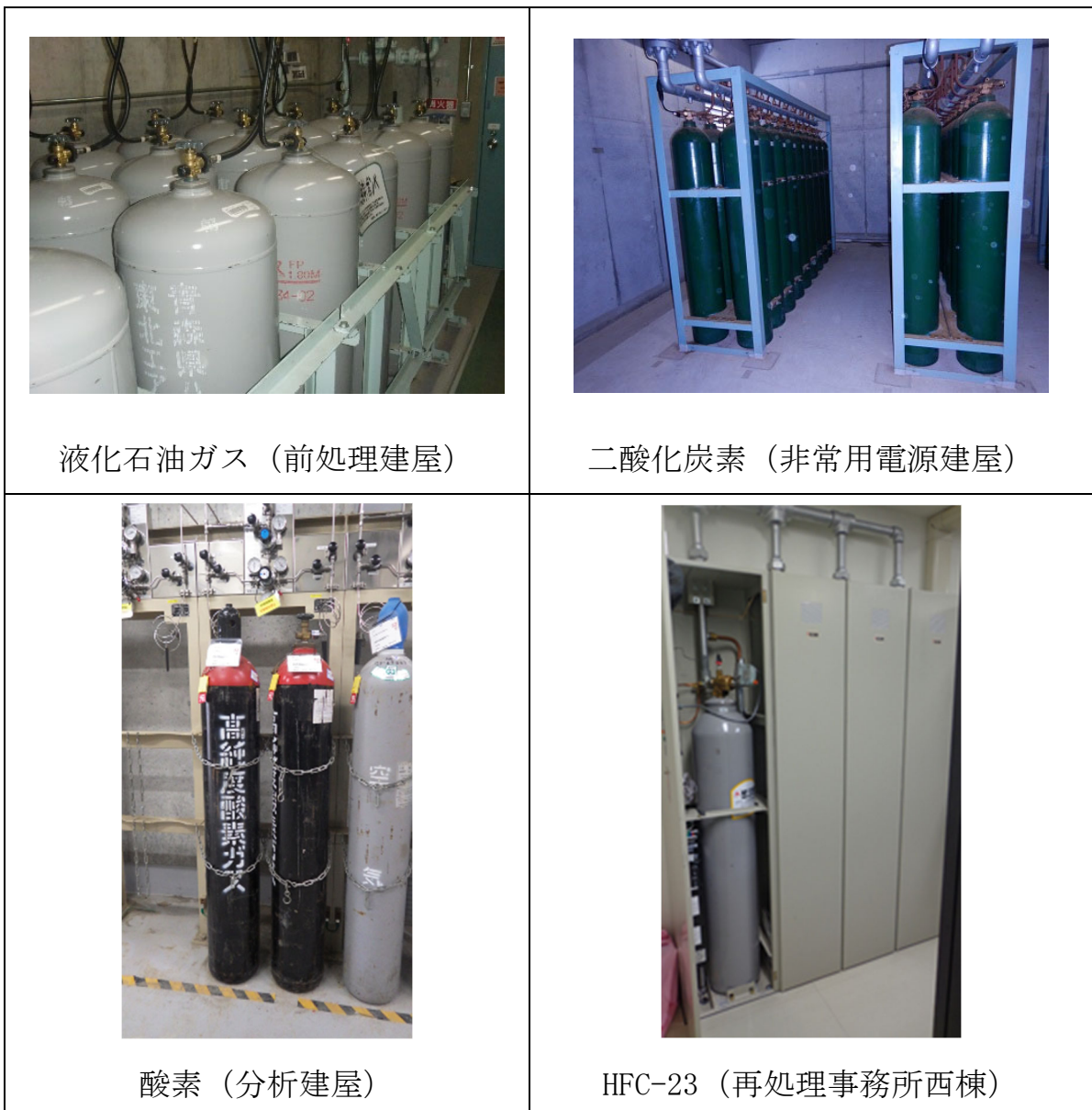
第2図 再処理施設における高圧ガス容器の保管状況
