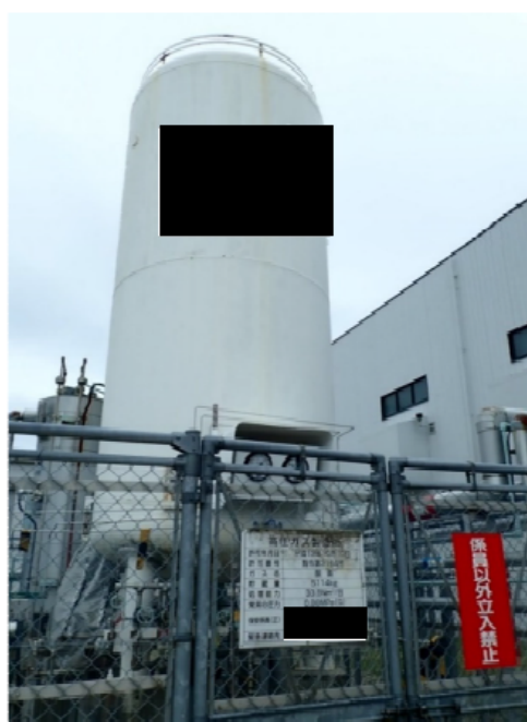
第1図 液化酸素タンクの設置状況
