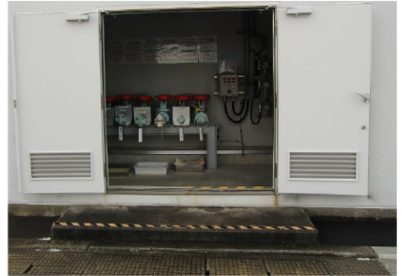
接続口の扉（開放）
