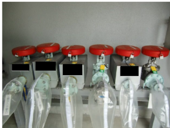
化学薬品の接続口
