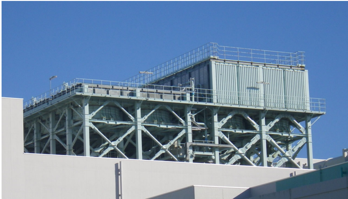
17. 冷却水設備：安全冷却水 A 冷却塔 (前処理建屋北東地上へ移設予定)
