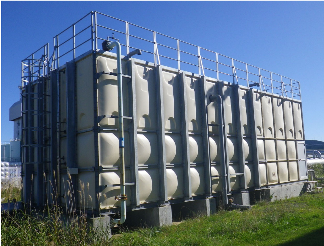
3. G2 常用冷却水設備：散水用水貯槽
