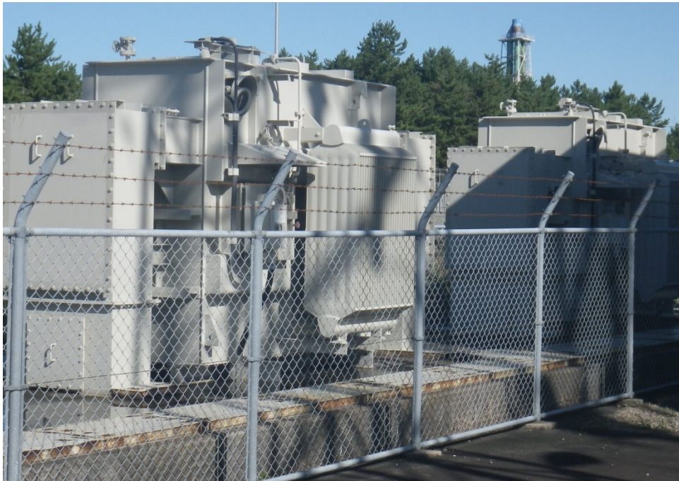
1. G1 開閉所：構内電源設備限流リアクトル D1/D2
