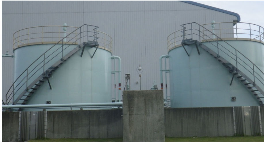
5. G4 ボイラ用燃料貯蔵所：燃料油サービスタンク A/B
