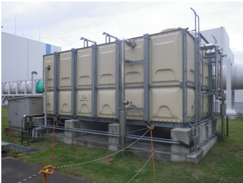
15. H2W 再処理事務所 西棟：受水槽
