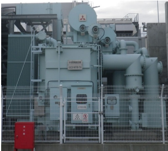
13. GC2 第2ユーティリティ建屋：3号/4号受電変圧器
