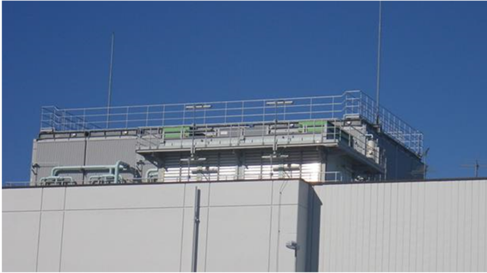
9. G8 先行常用冷却水製造設備：冷却塔，膨張槽
