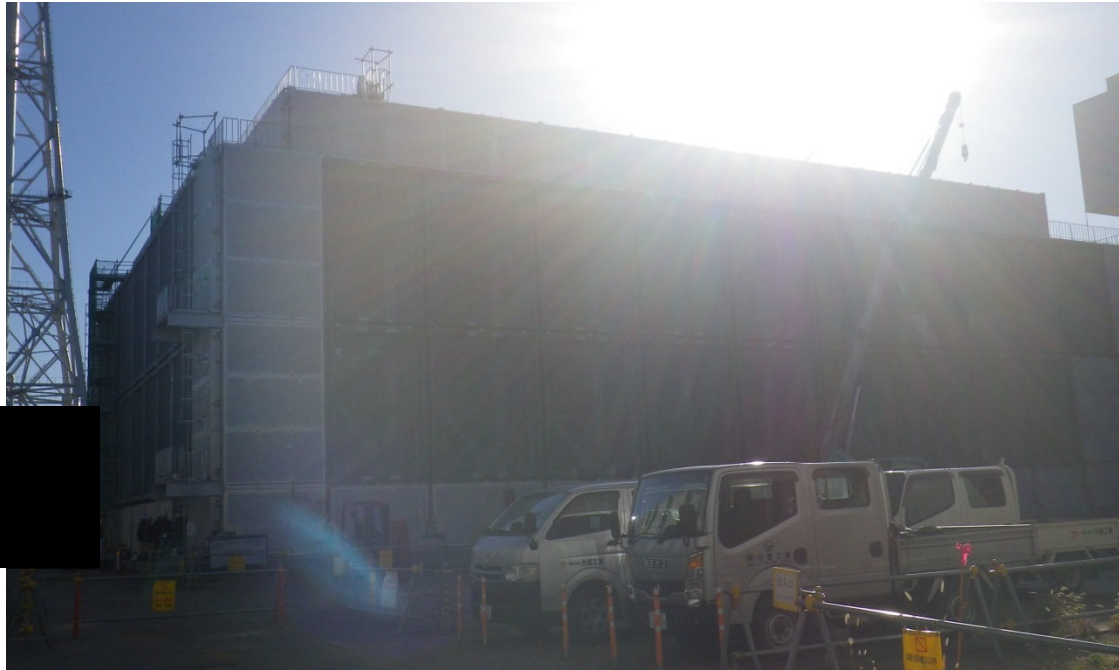
19. 使用済燃料受入れ・貯蔵施設用冷却水設備： 安全冷却水系冷却塔 A/膨張槽 A
