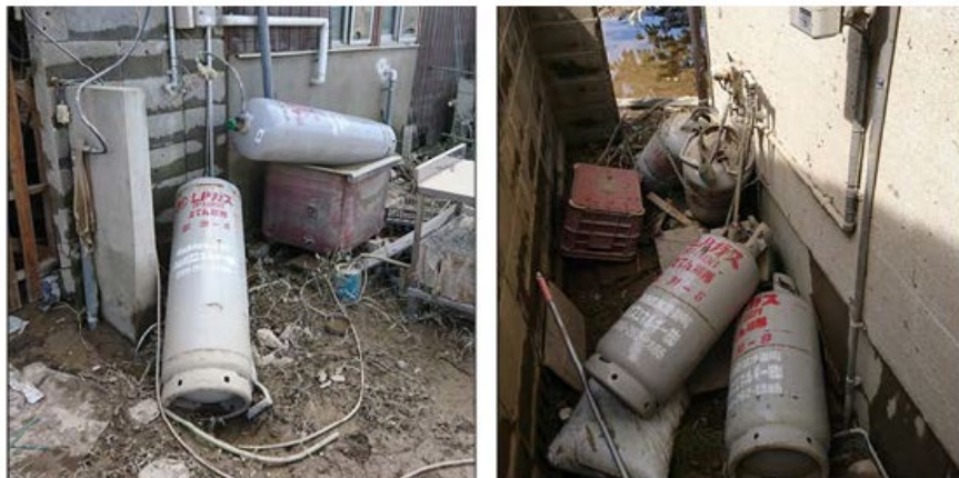
第1図 西日本豪雨による浸水後のLPガス容器の状況
