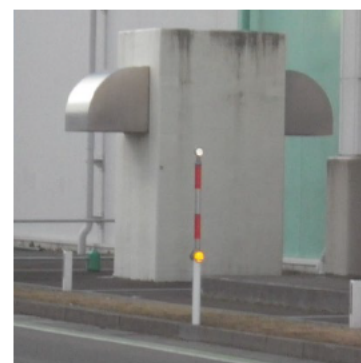
洞道の排気口
