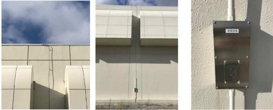
・避雷設備（左から、棟上導体・引下げ導線・端子箱）
