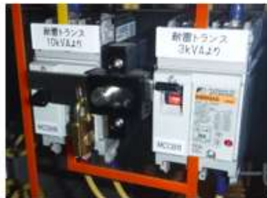
分電盤 (メカニカルインターロック部)
