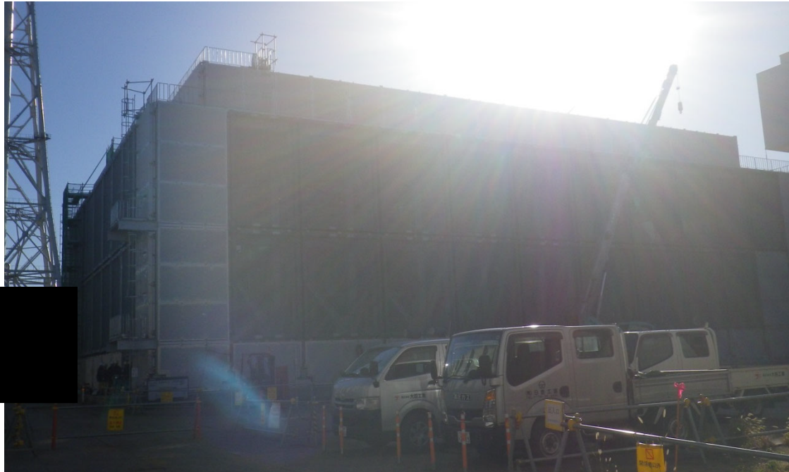
19. 使用済燃料受入れ・貯蔵施設用冷却水設備： 安全冷却水系冷却塔 A/膨張槽 A
