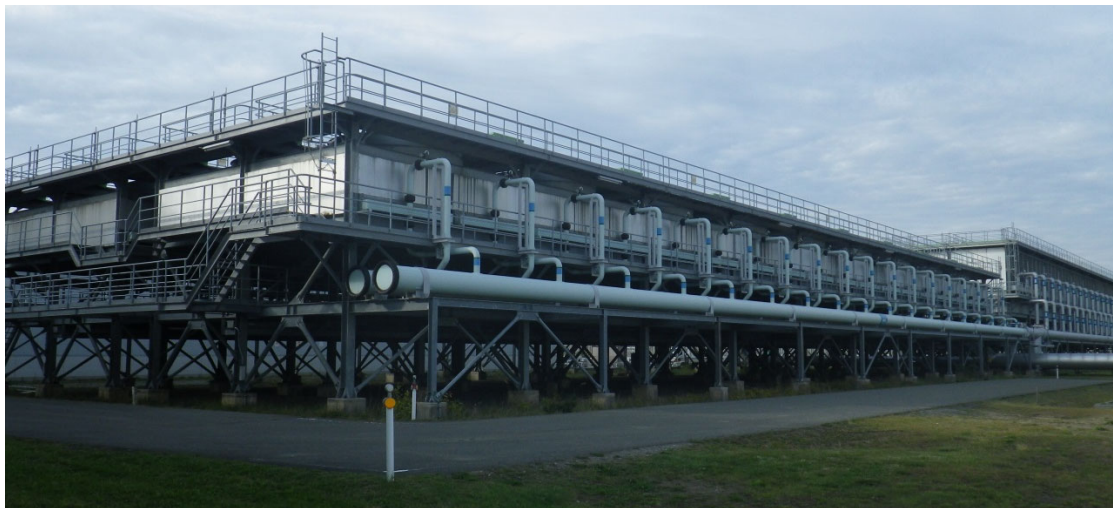
2. G2 常用冷却水設備：冷却塔
