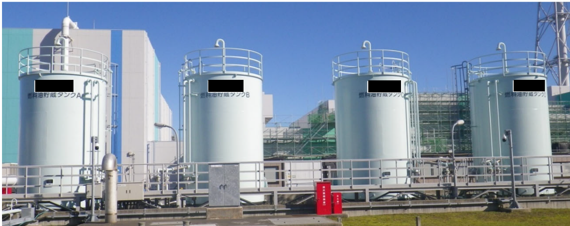
8. G7 ディーゼル発電機設備用燃料油受入れ・貯蔵所： 燃料油貯蔵タンク A/B/C/D
