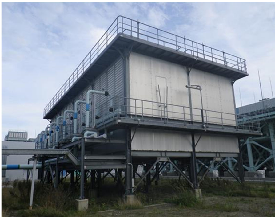
10. G9 運転予備用冷却水設備：冷却塔
