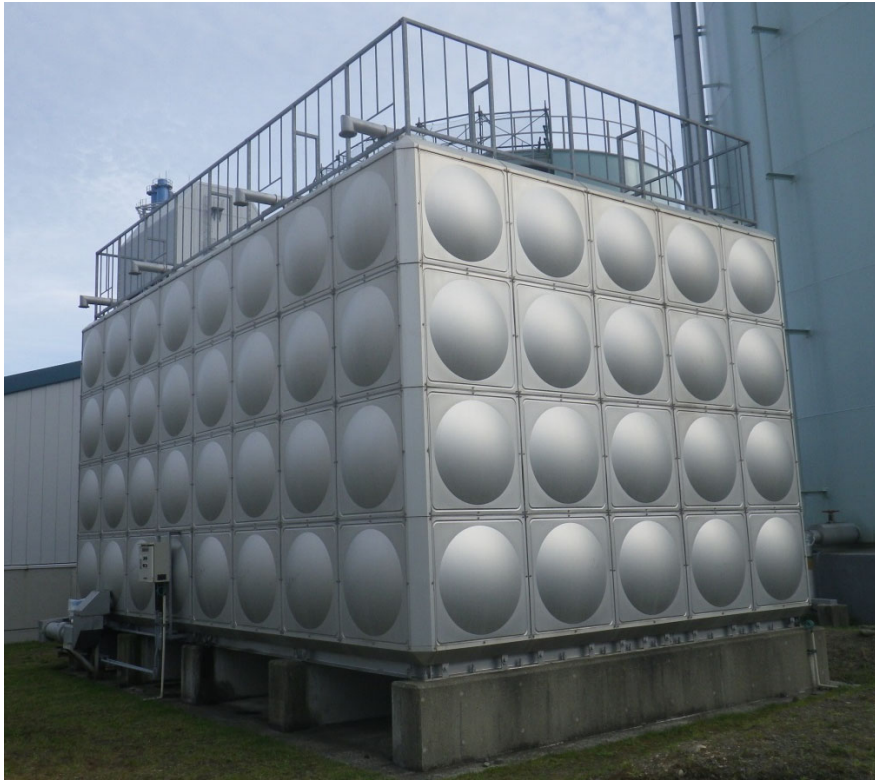
7. G6 工業用水施設：飲料水増設貯槽
