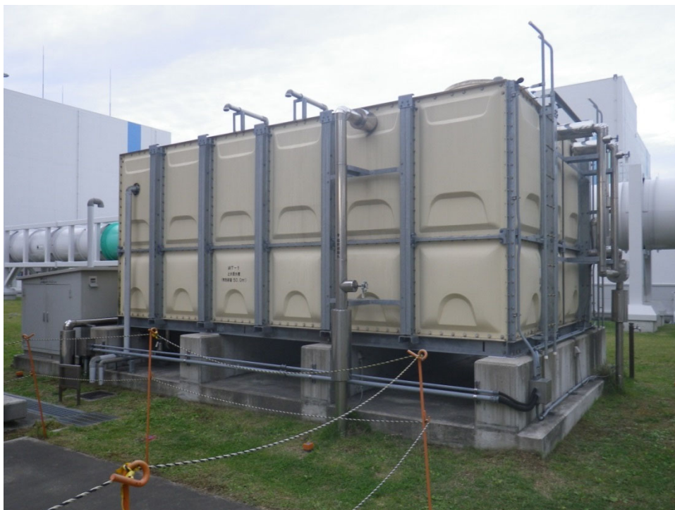
15. H2W 再処理事務所 西棟：受水槽
