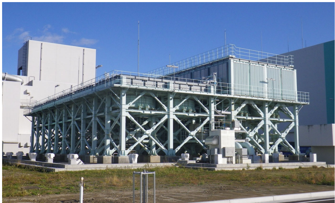
18. 冷却水設備：安全冷却水 B 冷却塔
