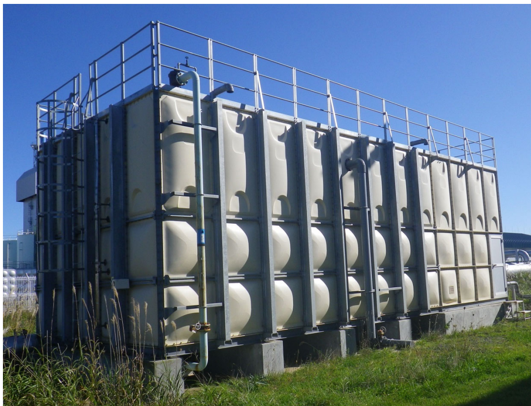
3. G2 常用冷却水設備：散水用水貯槽
