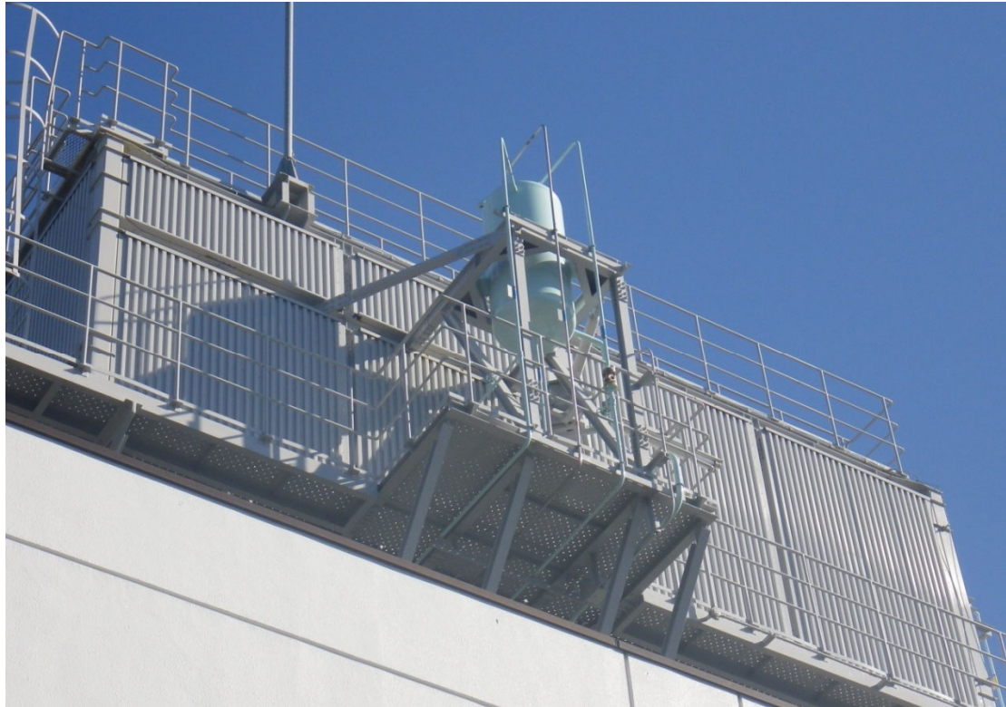
11. GC ユーティリティ施設：冷却塔，膨張槽
