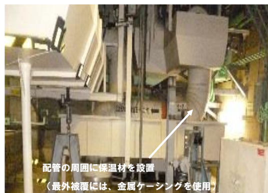
( 2 次主冷却系の配管 )
