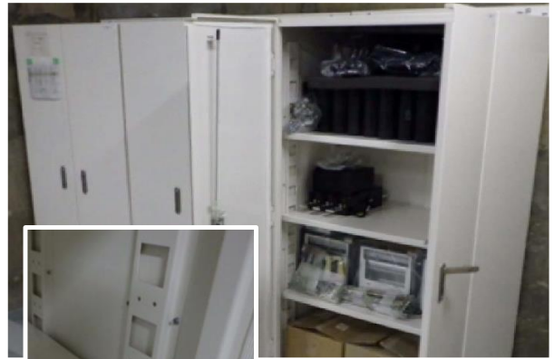
キャビネットの内部
