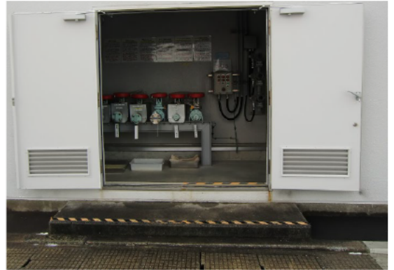
接続口の扉（開放）
