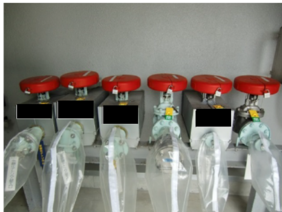
化学薬品の接続口
